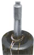
Vazamento de óleo
