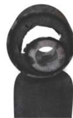
Orifícios de fixação danificados/ Bucha de olhal danificada.
